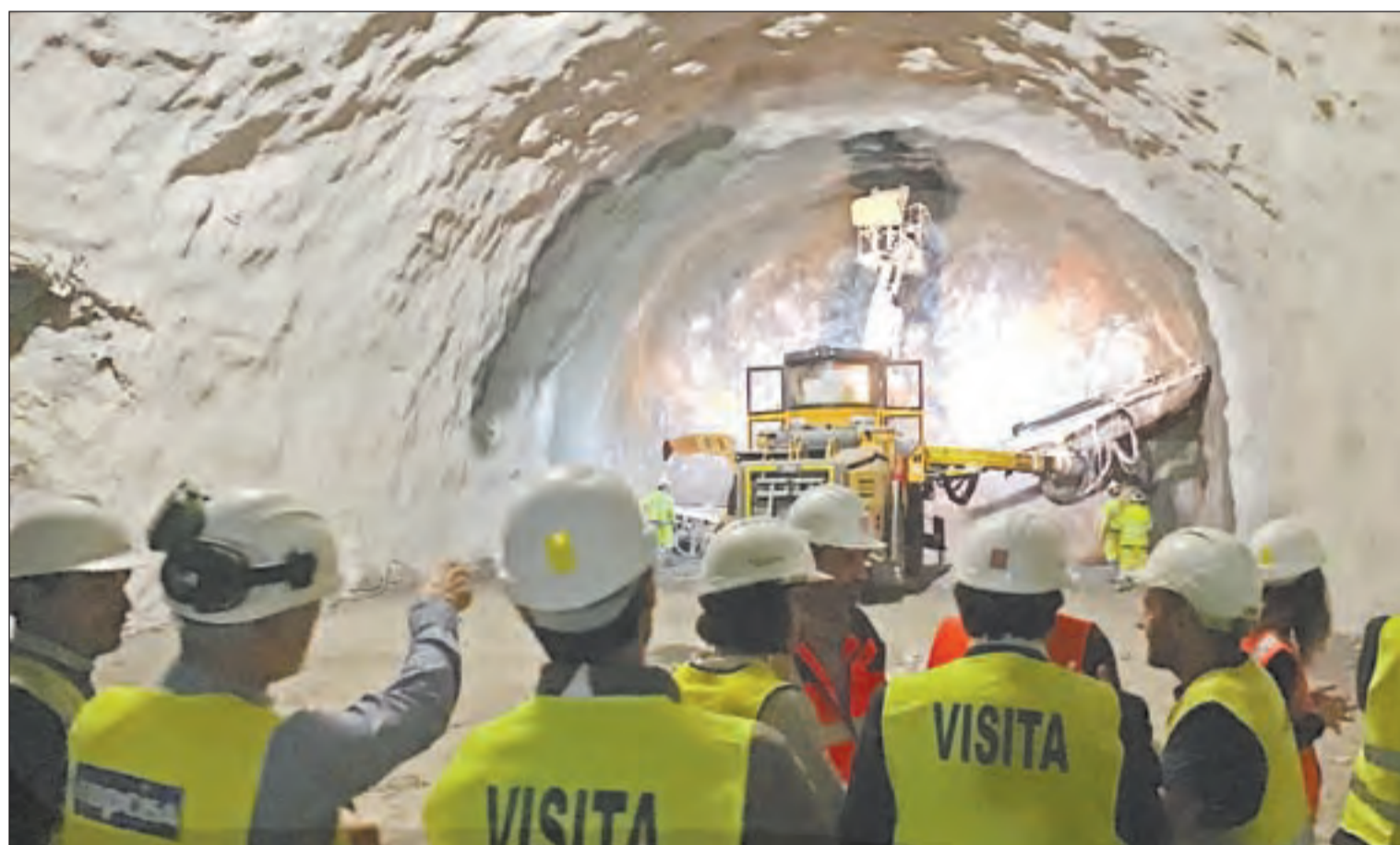
FOTO: Dep.Territori / El grup de seguiment de l'obra, que actua en el tram entre Organyà i Montant de Tost, va visitar ahir els treballs de perforació
